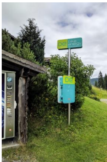
ABBILDUNG 22: LADEPUNKT FÜR PEDELECS IN ALTENMARKT IM PONGAU (EIGENES FOTO)
